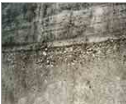
Beanspruchung durch Klärwasser
